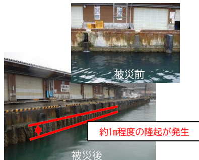
船だまりの被害状況
