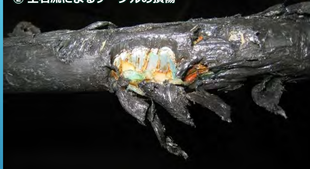
② 土石流によるケーブルの損傷
