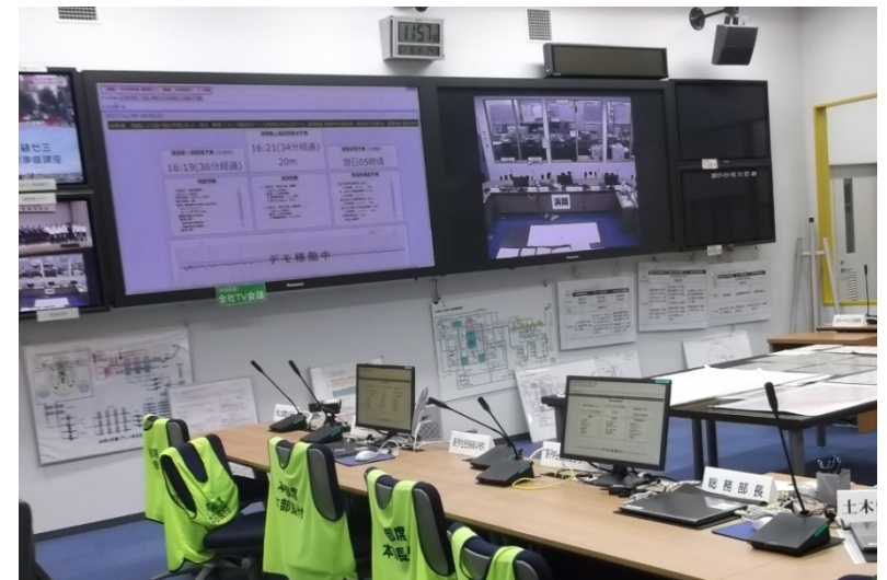
予測画面の表示 (浜岡発電所 緊急時対策所)
